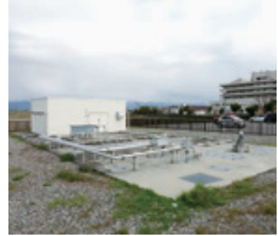
富山県リハビリテーション病院 合併処理浄化槽。
