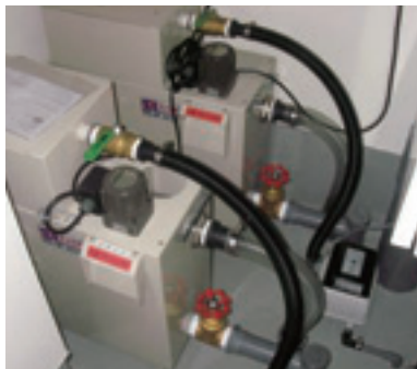
排水処理の故障は施設全体にかかわる。
